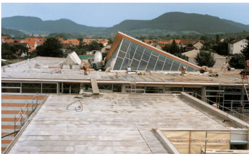
Zgrzewane liniowo pokrycie połaci dachowej ze stali nierdzewnej przed posadzeniem roślinności (po prawej) i po posadzeniu (dalej po prawej).
